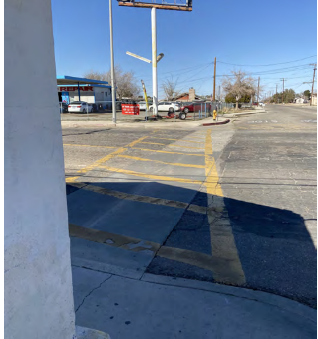
La huella del edificio en la esquina suroeste de la intersección de la Avenida Bartlett y la Calle Jonathan crea un punto ciego para conductores que giran a la derecha en la Calle Jonathan desde la Avenida Bartlett.
