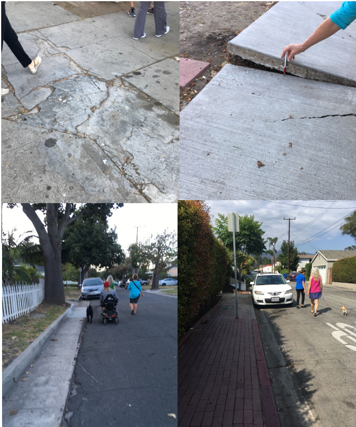
Pedazos de banquetas que faltan, banquetas estrechas, levantadas y agrietadas en la comunidad Westside.
