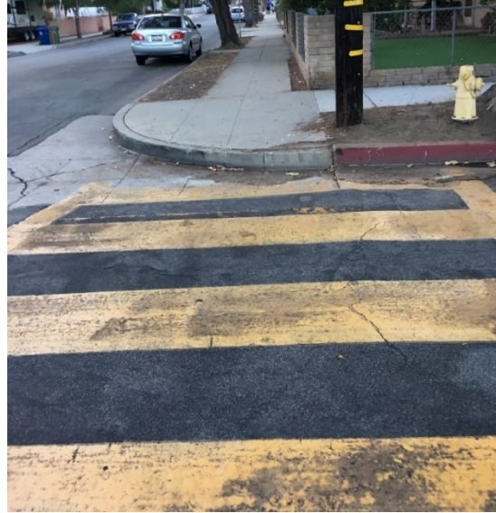
Las rampas de ADA (por sus siglas en inglés) que faltan y son inconsistentes crean desafíos de acceso y seguridad para quienes usan dispositivos de movilidad asistida.
