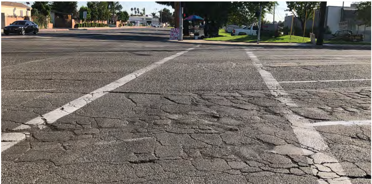
El paso de peatones occidental en la intersección de Avenida Placentia Sur y Avenida Orangethorpe está roto y representa un peligro de tropiezo para los peatones que cruzan esta intersección.
