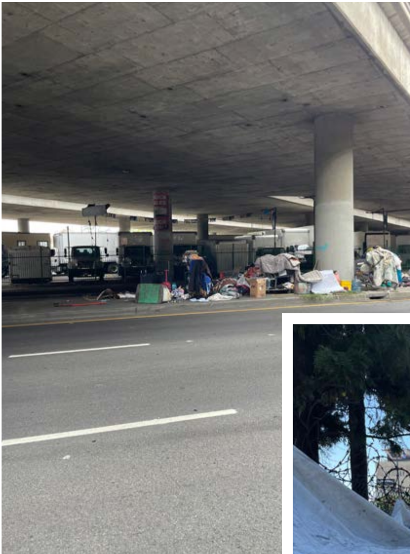
ARRIBA: La sección del bulevar West Washington, por debajo de la autopista, procura ser oscura, lo cual la hace sentir peligrosa por la noche y temprano por la mañana.
