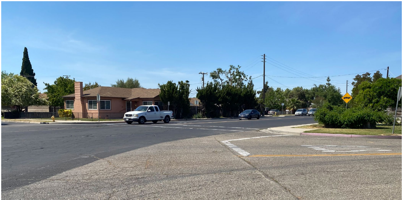
El paso de peatones norte de la intersección de cinco vías no está marcado y le faltan rampas en las banquetas.
