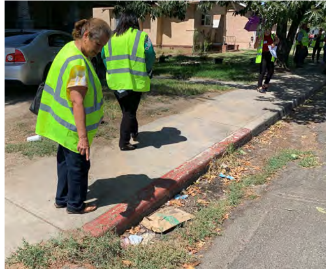
Un participante inspecciona una alcantarilla obstruida con vegetación, basura y maleza sobre cultivada a lo largo de la Calle Orange al sur.
