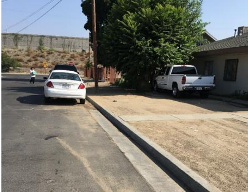
Falta banqueta a lo largo de la Calle Bond frente a la Marketta Bond.
