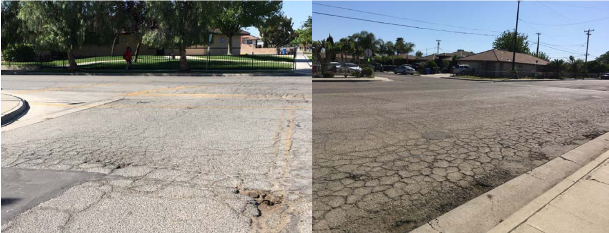
Paso de peatones y marca de medio carril descolorido en la intersección Haven Drive y calle South A, cerca de la escuela secundaria Haven Drive (foto a la izquierda). El pavimento agrietado y quebrado a lo largo de la calle South A (foto a la derecha).
