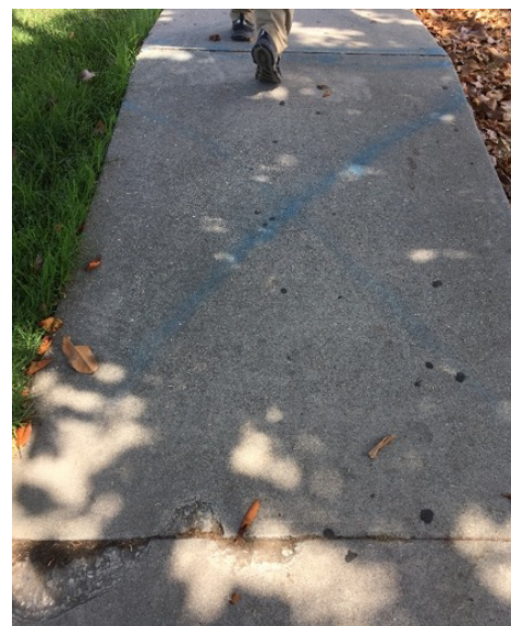
Banqueta levantada en un segmento sobre la avenida Enid, en frente de la preparatoria Gladstone.
